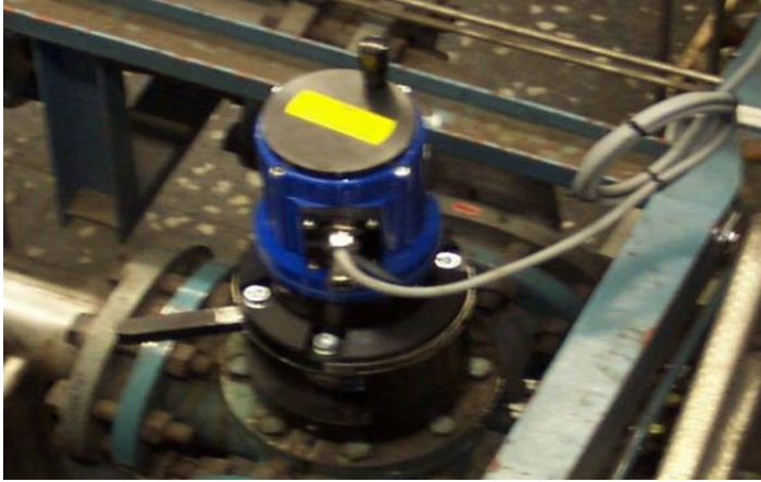
CONTROLE DE VAZÃO DE ÁGUA
