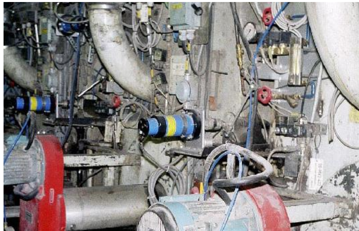
CONTROLE DE DAMPER
